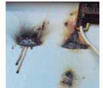
ホットスポット (発熱によるパネル破損)
